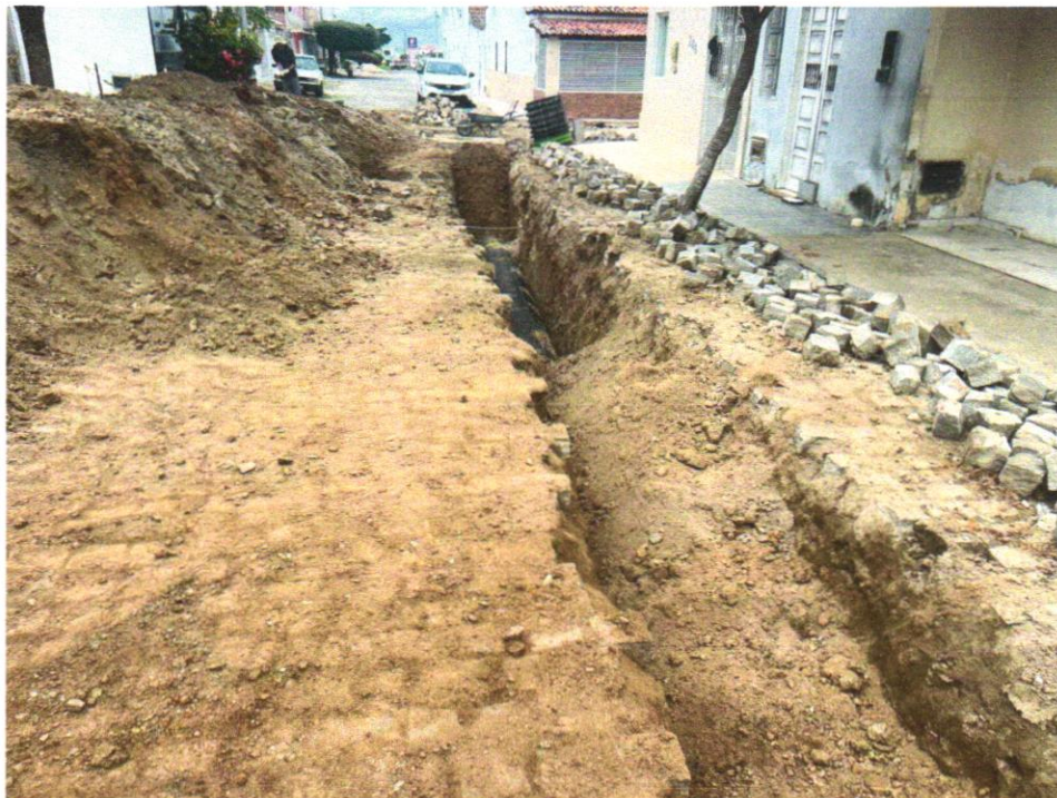
Foto 07 - ATERRO MANUAL COM SOLO ARGILO-ARENOSO IMPORTADO E COMPACTAÇÃO MECANIZADA EM CAMADAS DE 0,20 M NO MÁXIMO
